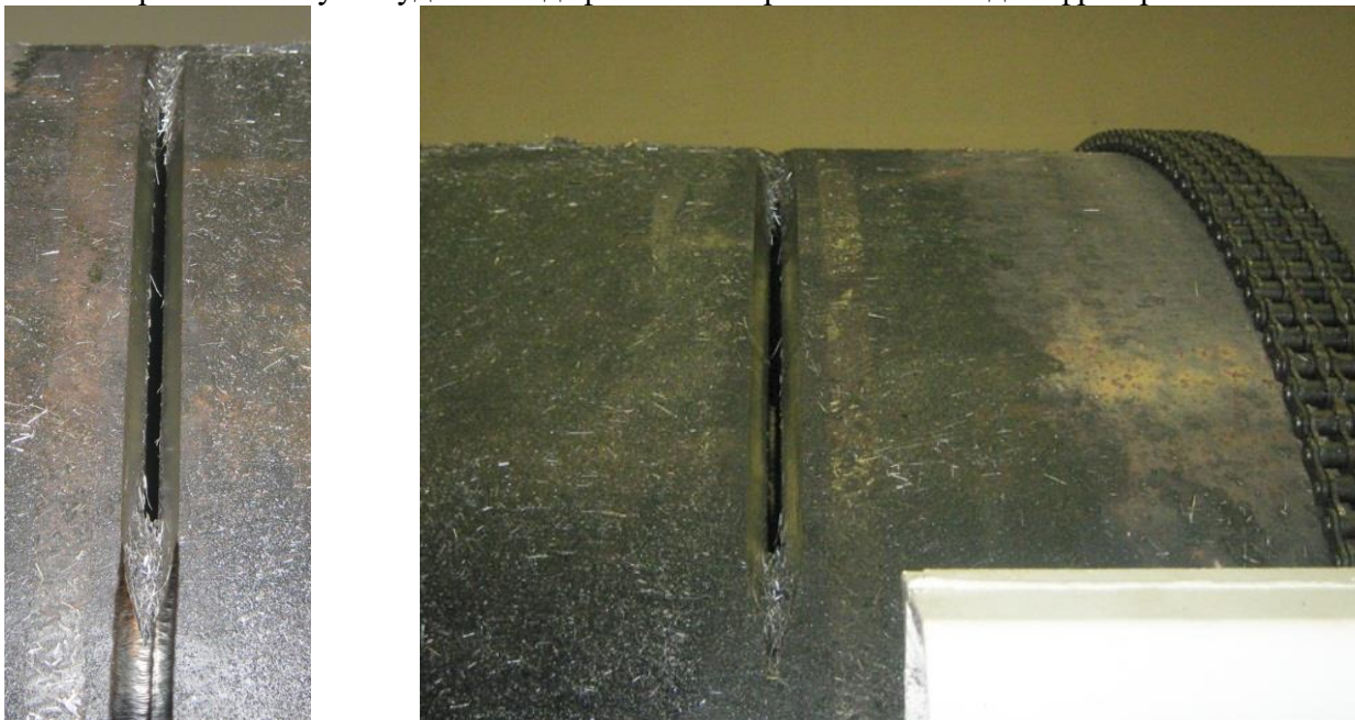
Рис. 7. Выборка сегментного дефекта сварного шва
